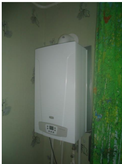
Газовый котел индивидуального отопления в деревянном доме
